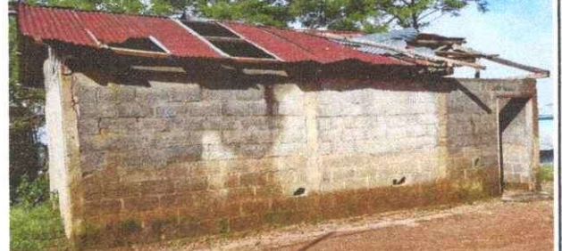
Foto 2: Techo de cocina en malas condiciones, sin puerta, paredes con agujeros.
