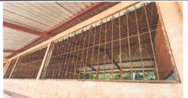
Foto 6: En esta fotografia se observa el deterioro de la pintura del balcon .
