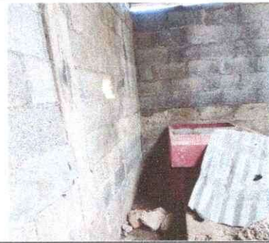
Foto 4: Cocina sin agua, sin chorro, sin torta de cemento.
