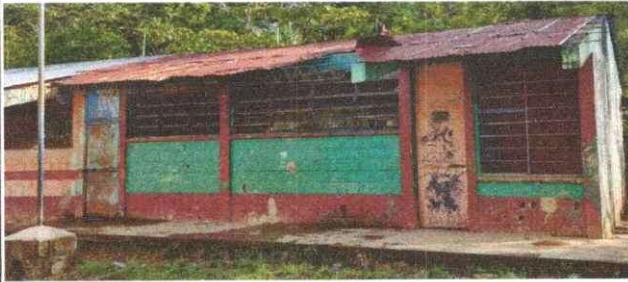
Foto 1: Techo deteriorado de aula 3, bodega y direccion. Puerta en mal estado, agujeros en la pared.
