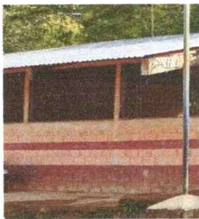
Foto 5: 3 aulas, dirección, bodega, cocina y baños sin pintura.
