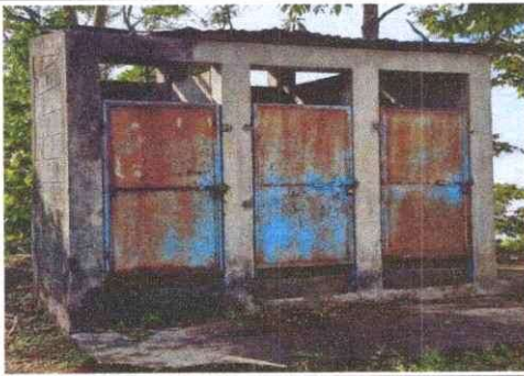
Foto 3: Techo y puertas deterioradas de los baños, agujeros en las paredes que dividen.
